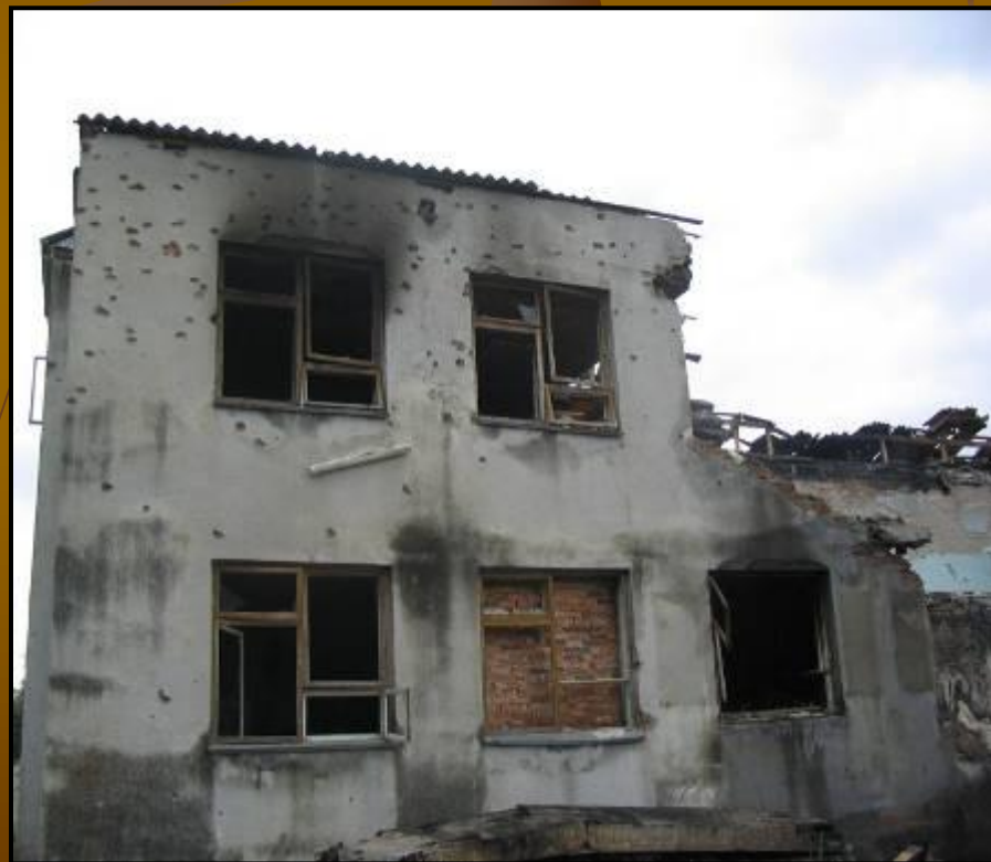
Школа, разрушенная в ходе теракта.
